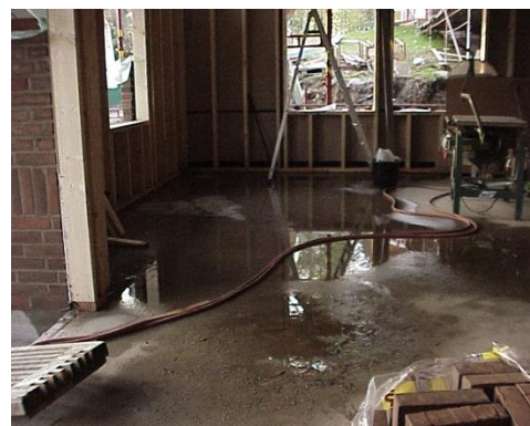
Bild 4. Byggfuktig innemiljö. (Foto: Anneling Tobin Consult AB.)
