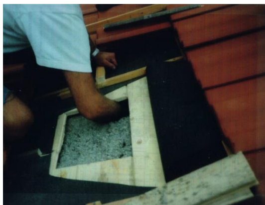
Bild 6. Fuktskador p.g.a. inbyggd fukt i parallelltak utan luftspalt.
