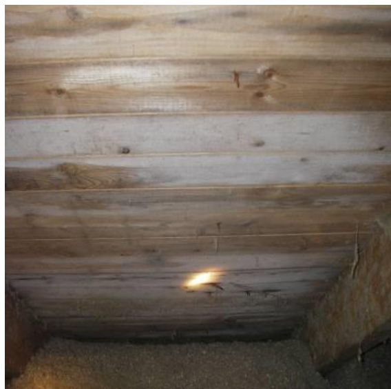
Bild 6. Om rimfrost uppkommer är det viktigt att eliminera orsaken, vilken ofta är en kombination av övertryck och inte alltför sällan en öppen vindslucka, och säkerställa uttorkning.
